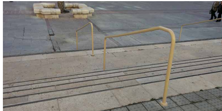
הנגשת הכניסה למבנה - הוספת מאחד יד בגובה מתאים וגבשושיות לסימון התחלה וסיום מהלך המדרגות
